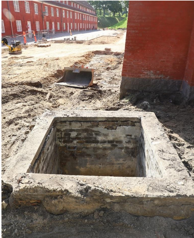
Figur 160 Den eksisterende brønd, SS14398, delvist afdækket. Set mod SSØ. KBM4068_IMG_2445. Københavns Museum
