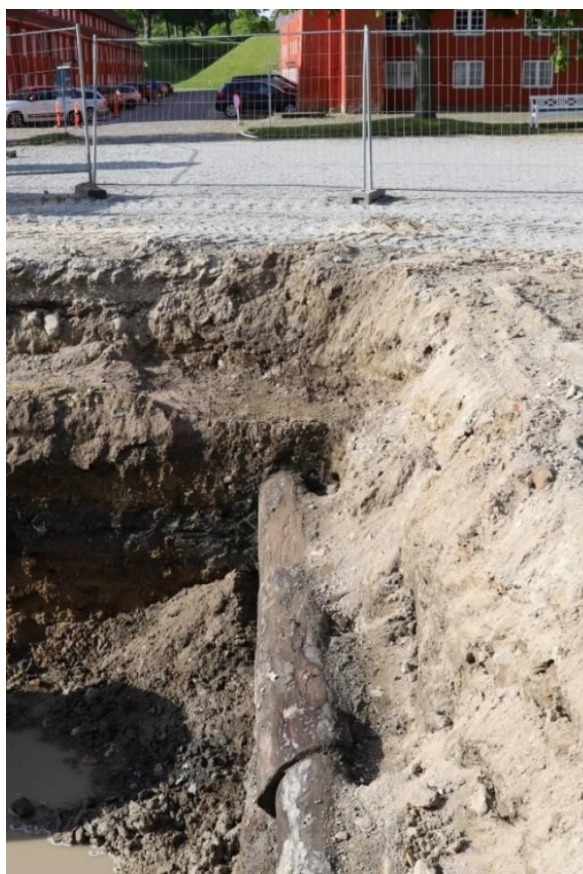
Figur 165 Trævandreret ST2591 set mod syd i juni 2020. I baggrunden ses overdækningen af den eksisterende brønd ved Søndre Magasins NØ-hjørne. KBM4068_IMG_0813. Københavns Museum
