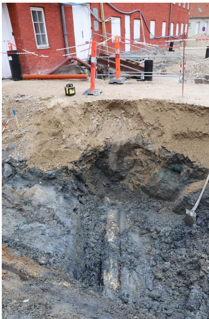
Figur 169 Det nordligst dokumenterede stræk (ST14477 og ST14485) af den N-S-orienterede trævandledning, SG200058. Her set ud for porten ind i Nordre Magasins østside. Set mod NNV. KBM4068_IMG_2457. Københavns Museum
