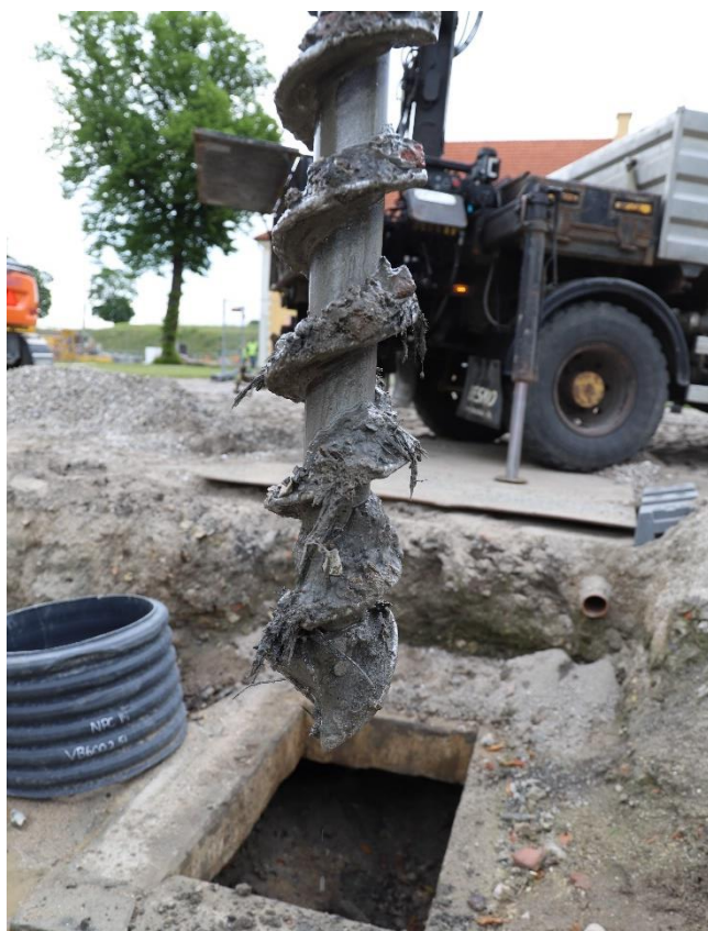
Figur 155 Geoteknisk boring i brønden. Ca. 3,5 m under sandstensrammens underkant fremkom træsplinter, der tolkes som bunden af anlægget. KBM4068_IMG_0838. Københavns Museum
