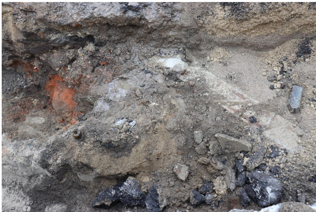
Figur 12. IMG_0543: I200029. Rester af fundament anes til venstre, med tværgående rør igennem hele grøften samt kabelboks af beton. Københavns Museum .
