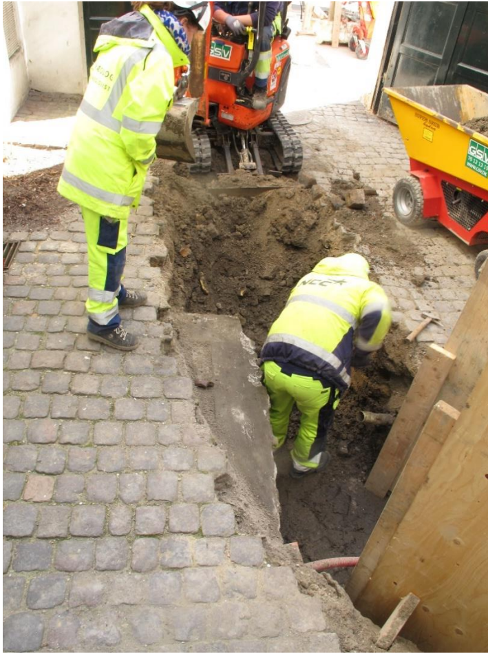
Fig. 7. Der graves med håndkraft i gården foran bygningen på Larsbjørnsstræde 1. Foto: C. Seehusen, Københavns Museum.
