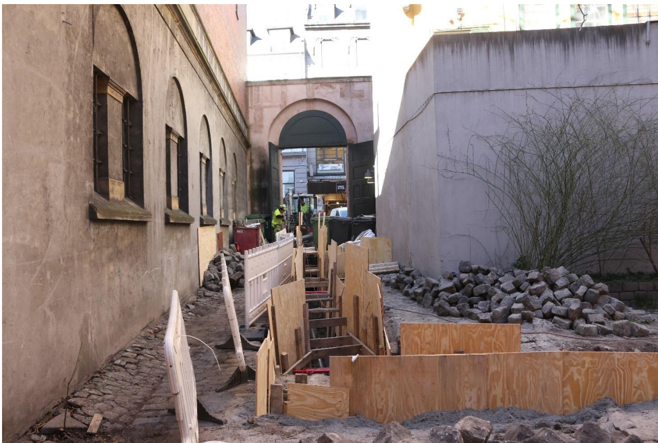
Figur 49. Oversiktsfoto av grøftegraving i bakgården til Fredriksberggade nr. 7 sett mot NV. Foto: Københavns Museum.
