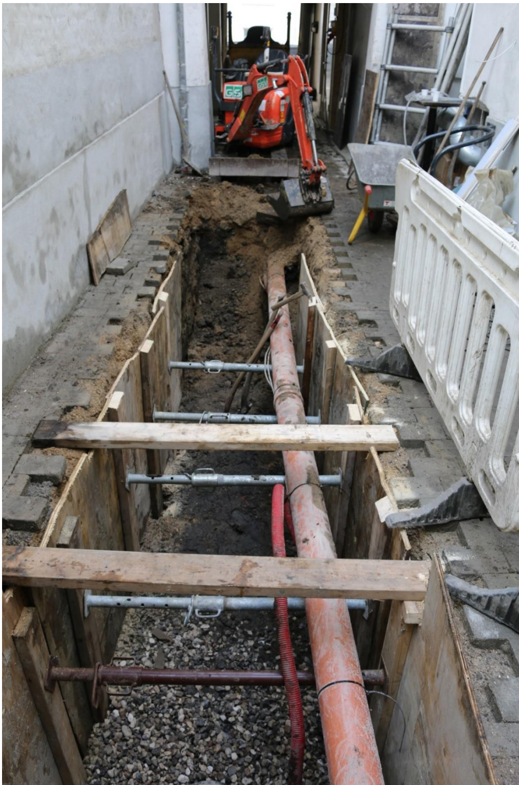
Figur 36. Arbeidsbilde. Grøftegraving i bakgård/passasje til Vestergade nr. 17 sett mot NV. Foto: Københavns Museum.
