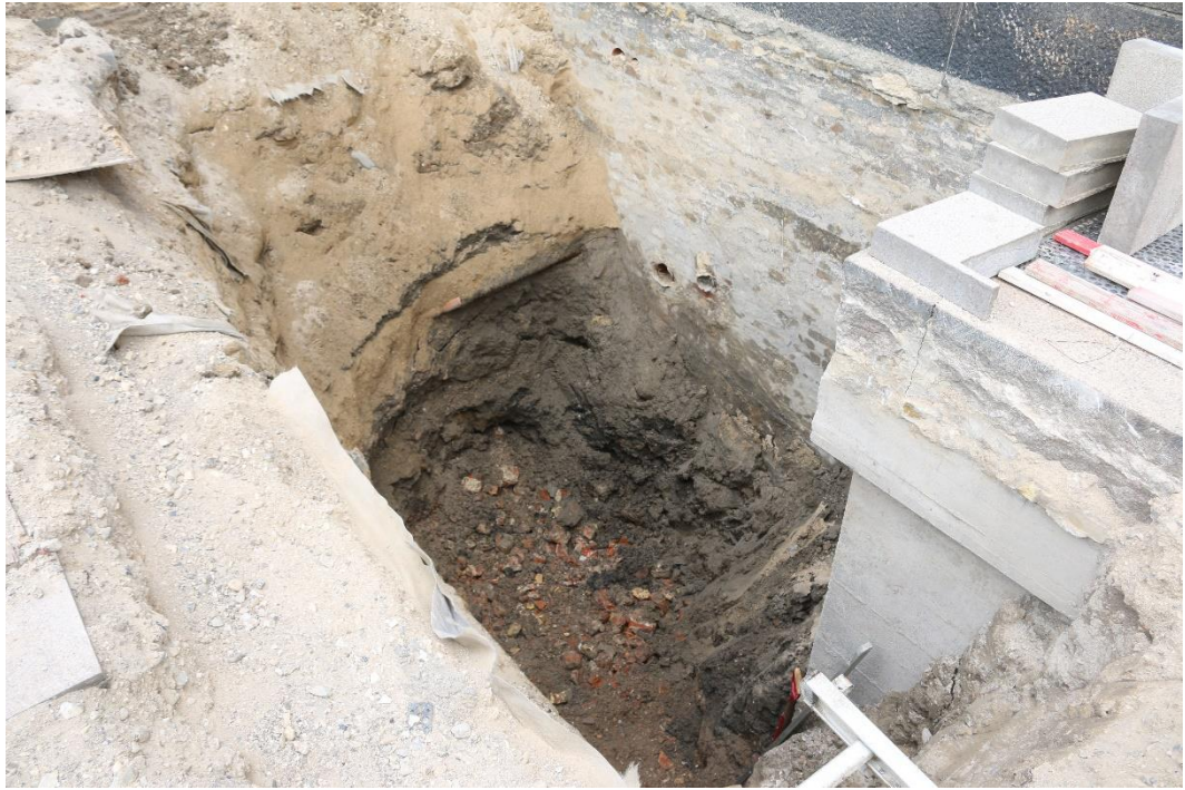
Fig. 13 Det første hul til placering af tank, i en dybde af 3,5 meter. Her ses fortsat et tykt lag af stabilgrus efterfulgt af et omrodet lag af løst jord og en masse teglsten og brokker.
