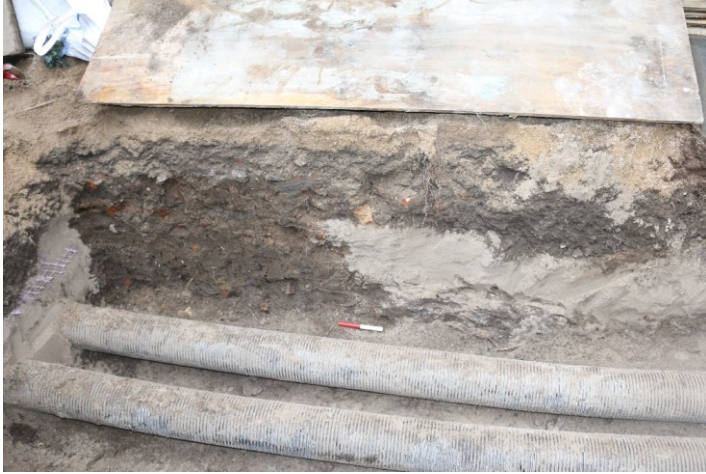
Fig. 21. Etape 3, fjernvarmerør blotlagt. Sandopfyld omkring rørene skelnes nemt fra de mørke kulturlag. Foto: C. Seehusen, Københavns Museum.
