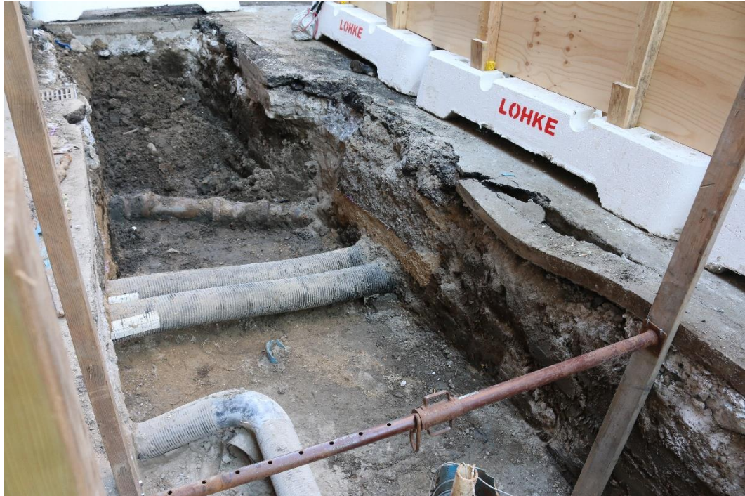
Fig. 8. Den sydvestlige del af grøften når den var næsten gravet færdig, set fra NØ. Opfyldslag med fund i profilen til højre, og i enden af grøften til venstre. (Foto nr. 18 i fotolisten)
