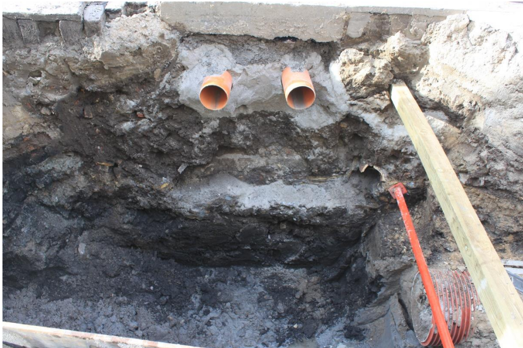
Fig. 17. Sort fugtigt kanalfyld i Frederiksgade. Under de to rør, ca. 1,5 m ned fra gadeniveau, er en betonblok (her dækket med grå sand som er faldet ned) der ligger direkte ovenpå kanalfyldet. Set fra NØ. (Foto nr. 87 i fotolisten)
