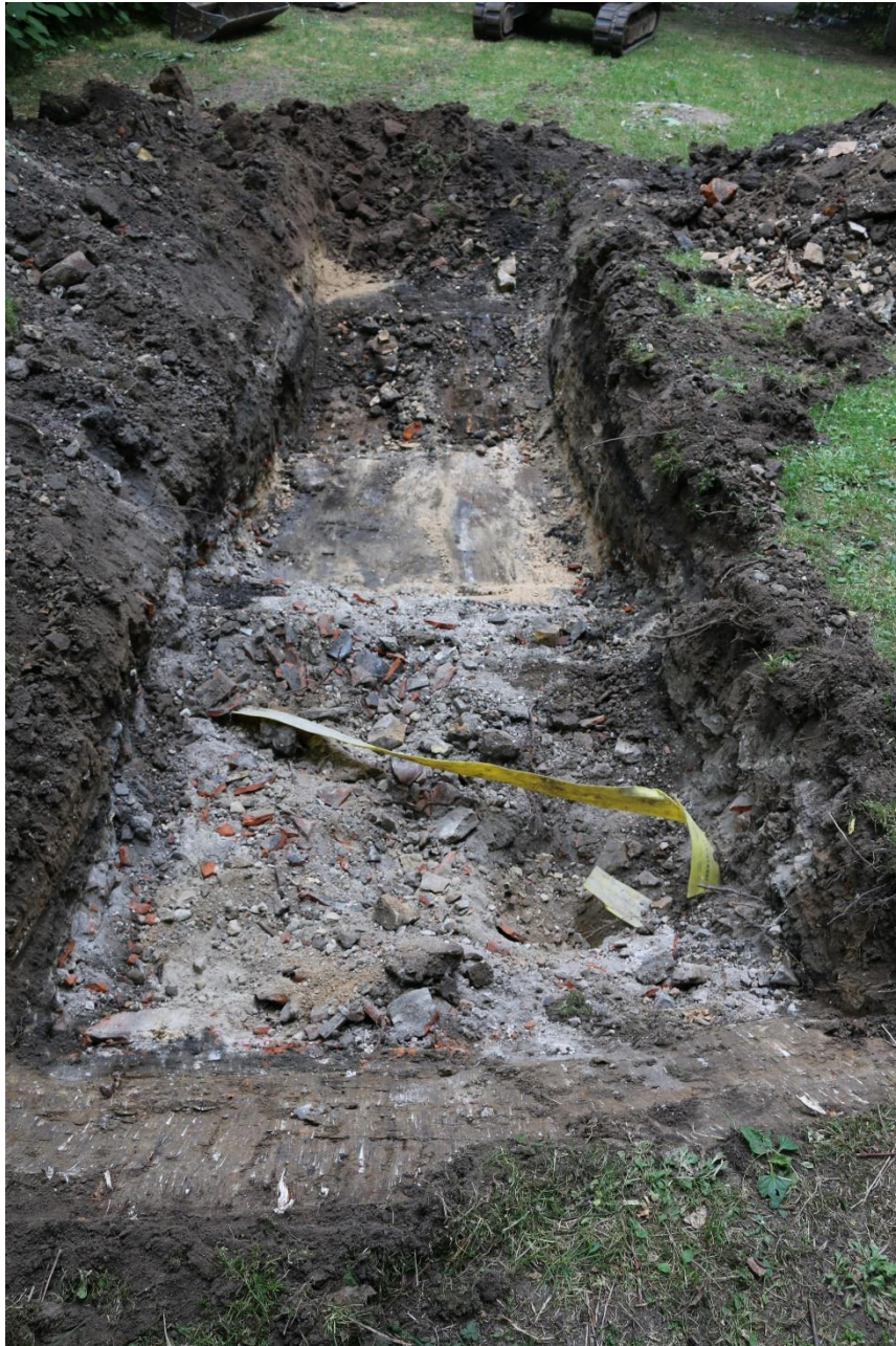
Figur 5. Grøft nr. 4 med varselbånd til sterkstrømskabel, betongkasse og moderne oppfyll sett mot NØ. Foto: Københavns Museum.
