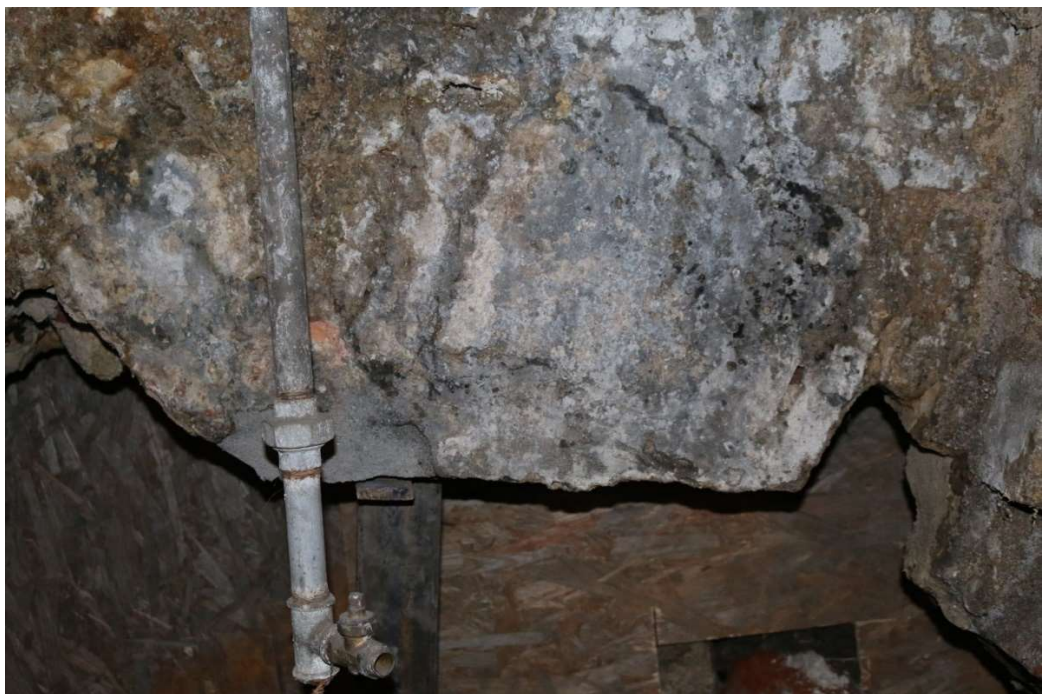
Figur 16. Stærkt skadet aflastningsbue 4 bestående af hollandske mopper. Foto: Københavns Museum.
