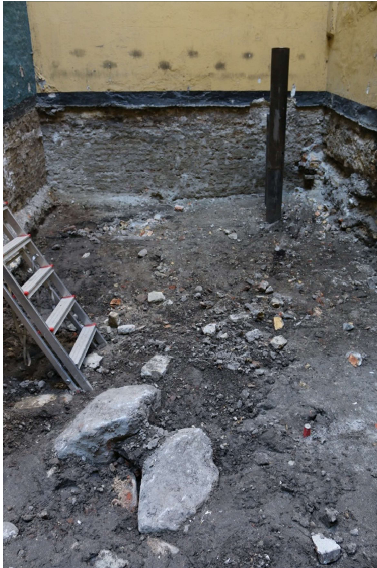
Figur 4. Baggård med murværk og to mulige fundamentsten i Købmagergade nr. 27 set mod SV. Foto: Københavns Museum.
