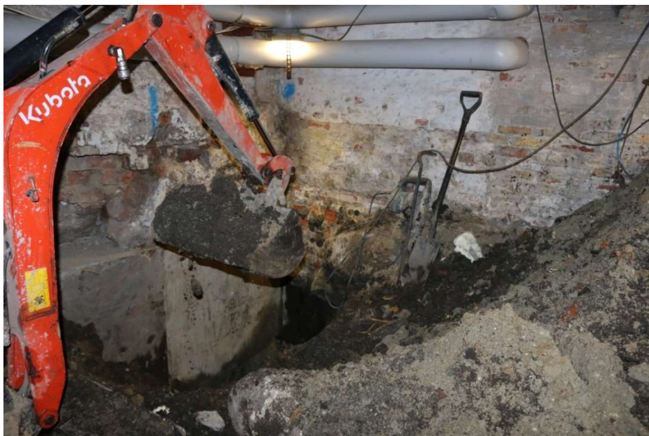
Figur 11. Gravning til pælefundering langs med fundamentet og kælderlokalets SV hjørne. Foto: Københavns Museum.
