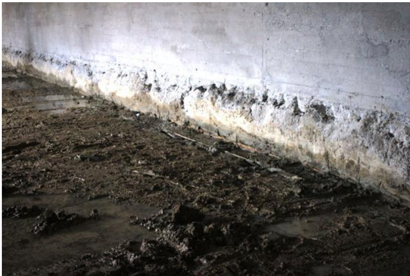
Figur 7. Restene av det nedbrutte terrengdekk ses på magasinbygningens vegg inn mot vollen sett fra NØ. I den avgravde leiren ses også spunten fra anleggelsen av bygningens fundament. Registreringen inne i bygningen vanskeliggjortes av et høyt grunnvannsnivå. Foto: Københavns Museum.
