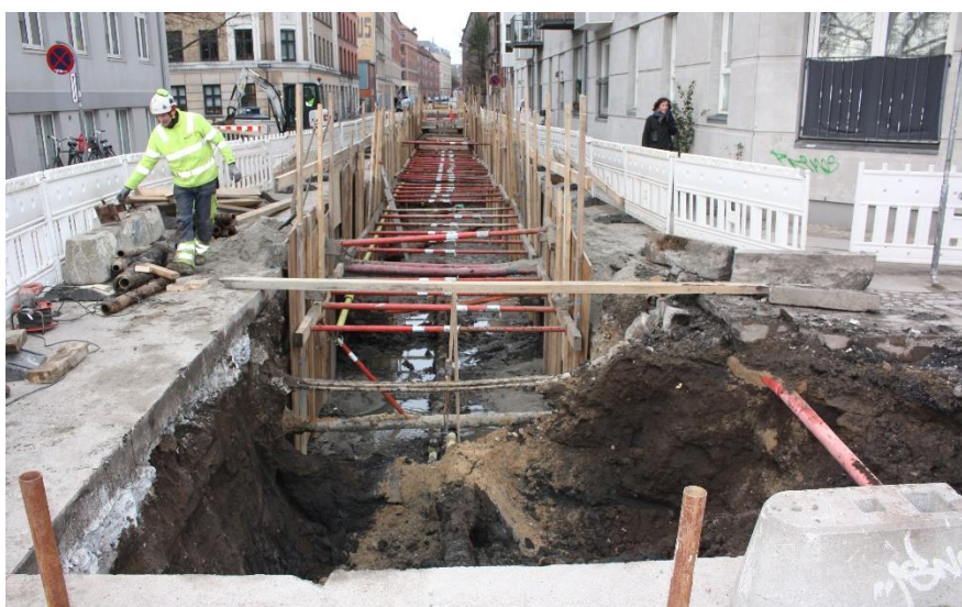
Figur 6. Fjernvarmegrøften i Baggesensgade set mod nordvest. Det ældre forsyningsrør anes i midten af grøften.
