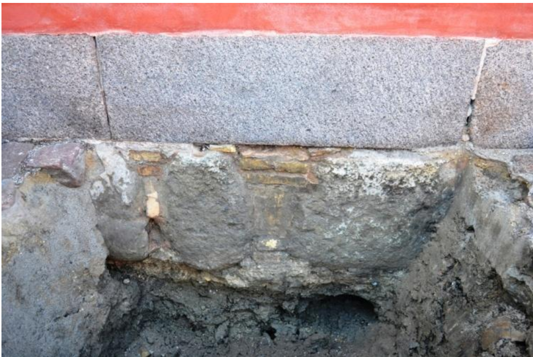
Figur 11. Artilleristok: Kombineret syld- og teglstensfundament under sokkelstenene.
