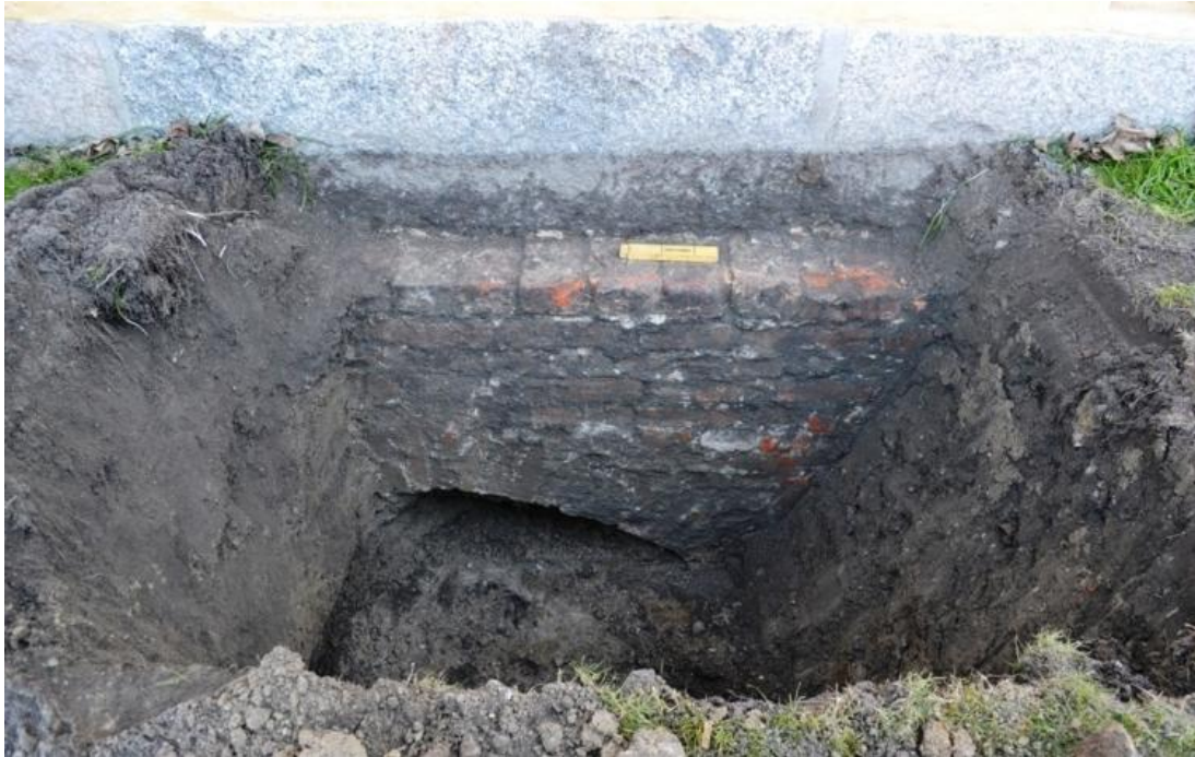
Figur 8. Den blotlagte aflastningsbue i hullet ved Kommandantgårdens facade.
