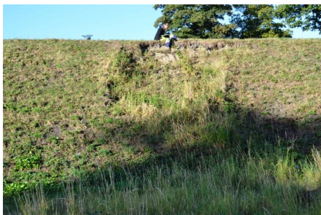
Figur 4. Oversigt over Skade 1 set mod sydvest.
