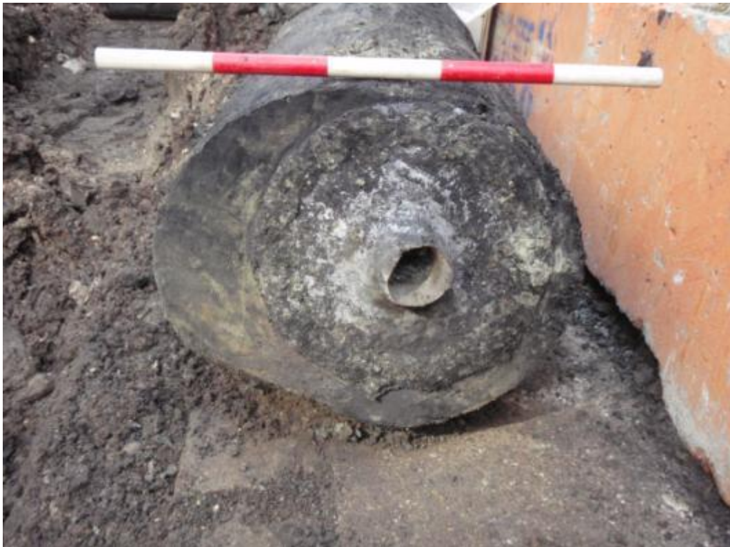
Figur 50. Stikledningens 100052 rørstub ses ført over i den meget store nitteplade, der er pånaglet selve vandrøret.
